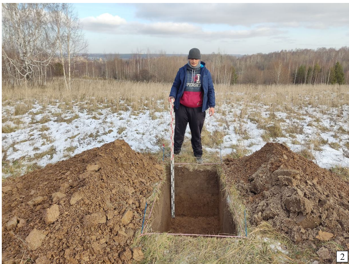
Рис. 60. Археологическая разведка по объекту «Капитальный ремонт автомобильной дороги Р-255 «Сибирь» Новосибирск – Кемерово – Красноярск – Иркутск на участке км 299+000 – км 309+000, Кемеровская область. Строительная площадка» (Березовский городской округ, Кемеровская область – Кузбасс). Шурф №7: 1 - общий вид до начала работ; 2 - общий вид после выборки. Везде вид на север.
