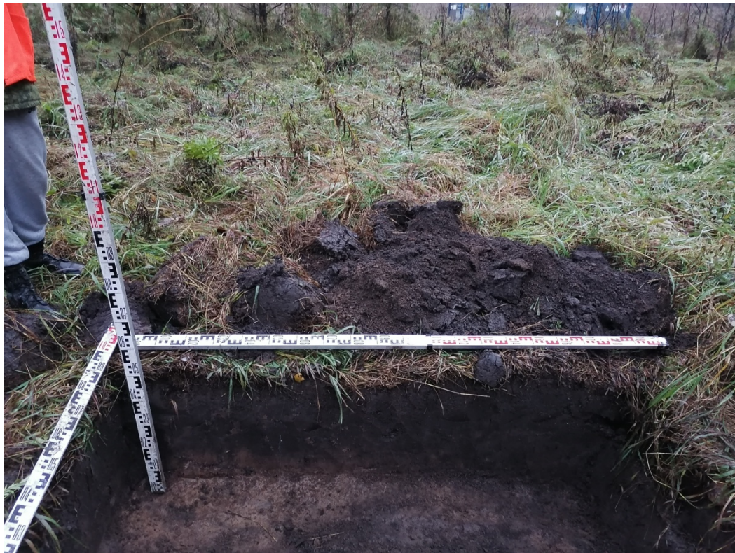
Рис.51. «МН Анжеро-Судженск-Красноярск, ДУ 1200мм, 0,0 - 68,216 км. Участок 51 км-54 км. Новосибирское РНУ. Реконструкция». Участок №1. Шурф №3. Северная стенка. Снято с Ю.
