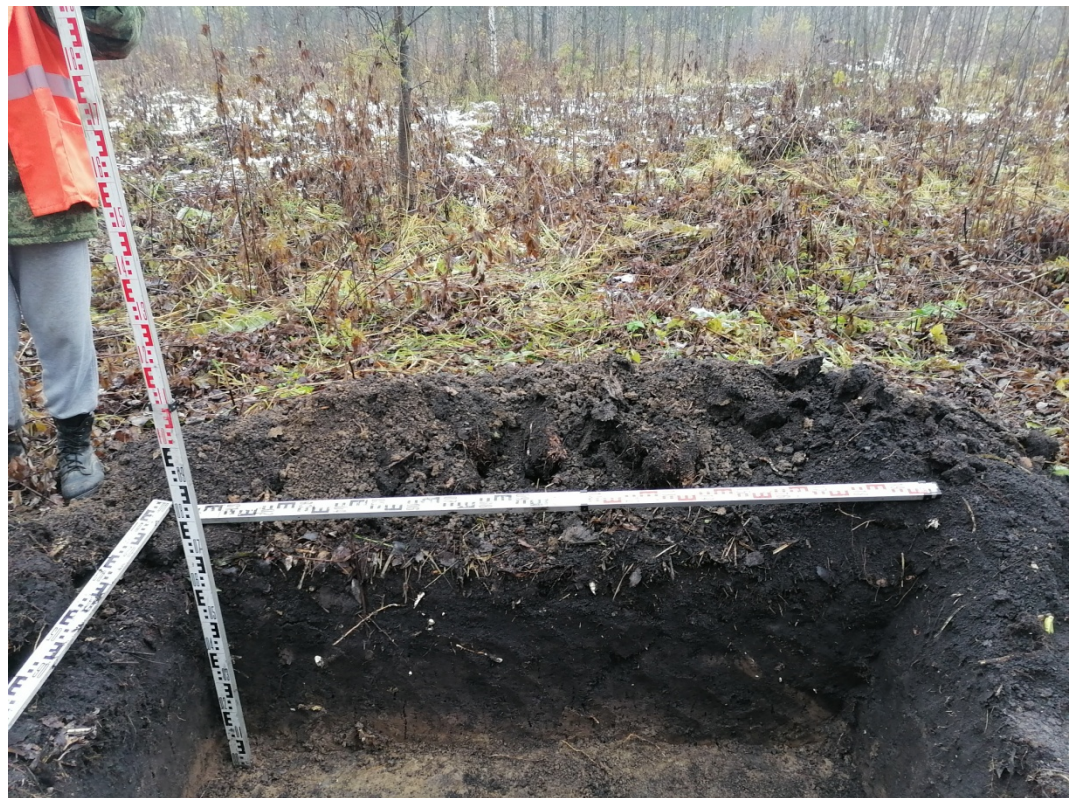
Рис.47. «МН Анжеро-Судженск-Красноярск, ДУ 1200мм, 0,0 - 68,216 км. Участок 51 км-54 км. Новосибирское РНУ. Реконструкция». Участок №1. Шурф №2. Северная стенка. Снято с Ю.
