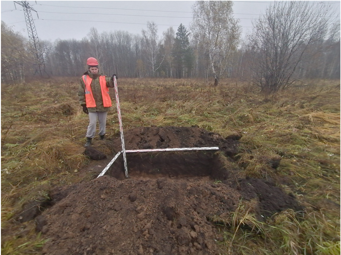
Рис.54. «МН Анжеро-Судженск-Красноярск, ДУ 1200мм, 0,0 - 68,216 км. Участок 51 км-54 км. Новосибирское РНУ. Реконструкция». Участок №2. Шурф №4. После работ. Снято с Ю.
