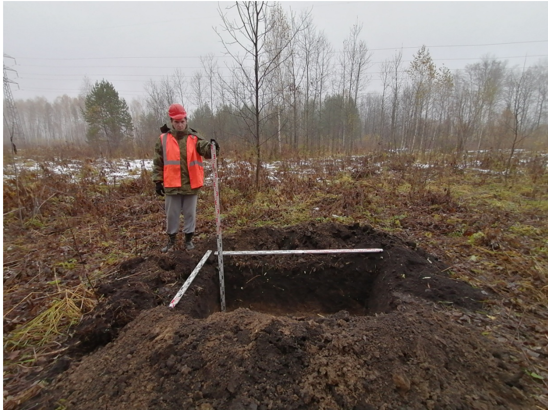
Рис.46. «МН Анжеро-Судженск-Красноярск, ДУ 1200мм, 0,0 - 68,216 км. Участок 51 км-54 км. Новосибирское РНУ. Реконструкция». Участок №1. Шурф №2. После работ. Снято с Ю.
