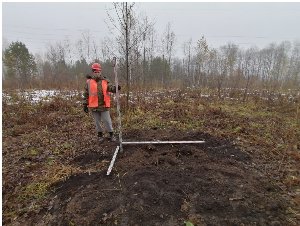
Рис.48. «МН Анжеро-Судженск-Красноярск, ДУ 1200мм, 0,0 - 68,216 км. Участок 51 км-54 км. Новосибирское РНУ. Реконструкция». Участок №1. Шурф №2. Рекультивация. Снято с Ю.
