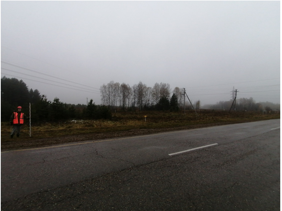
Рис.26. «МН Анжеро-Судженск-Красноярск, ДУ 1200мм, 0,0 - 68,216 км. Участок 51 км-54 км. Новосибирское РНУ. Реконструкция». ТФ №9. Вид участок №1. Снято с В.
