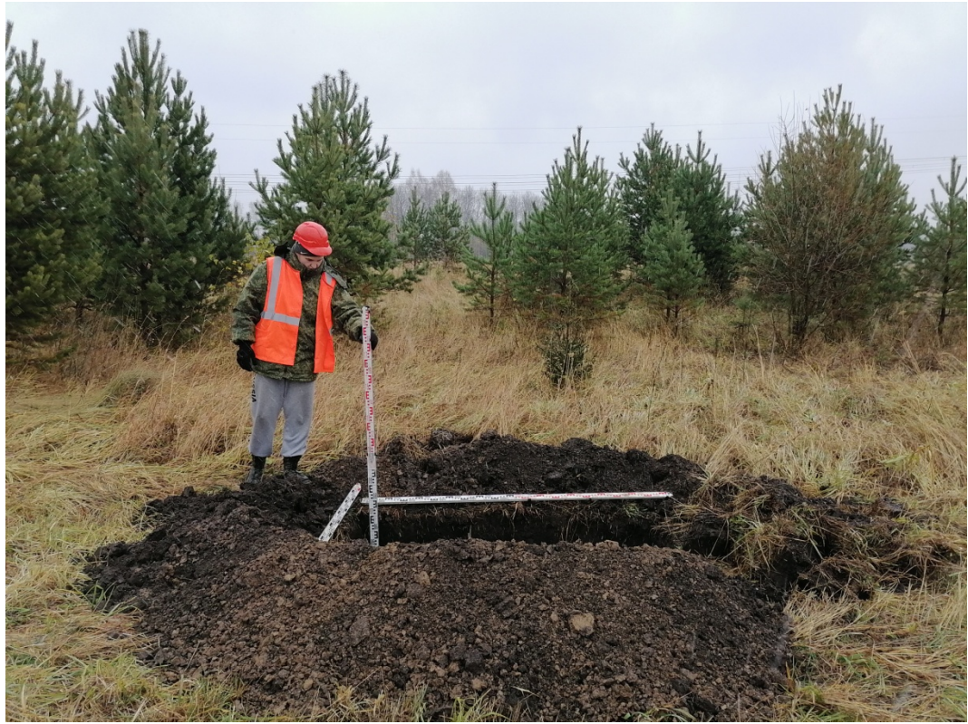
Рис.42. «МН Анжеро-Судженск-Красноярск, ДУ 1200мм, 0,0 - 68,216 км. Участок 51 км-54 км. Новосибирское РНУ. Реконструкция». Участок №1. Шурф №1. Вид после работ. Снято с Ю.
