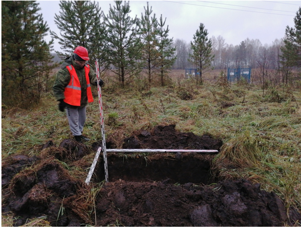
Рис.50. «МН Анжеро-Судженск-Красноярск, ДУ 1200мм, 0,0 - 68,216 км. Участок 51 км-54 км. Новосибирское РНУ. Реконструкция». Участок №1. Шурф №3. После работ. Снято с Ю.
