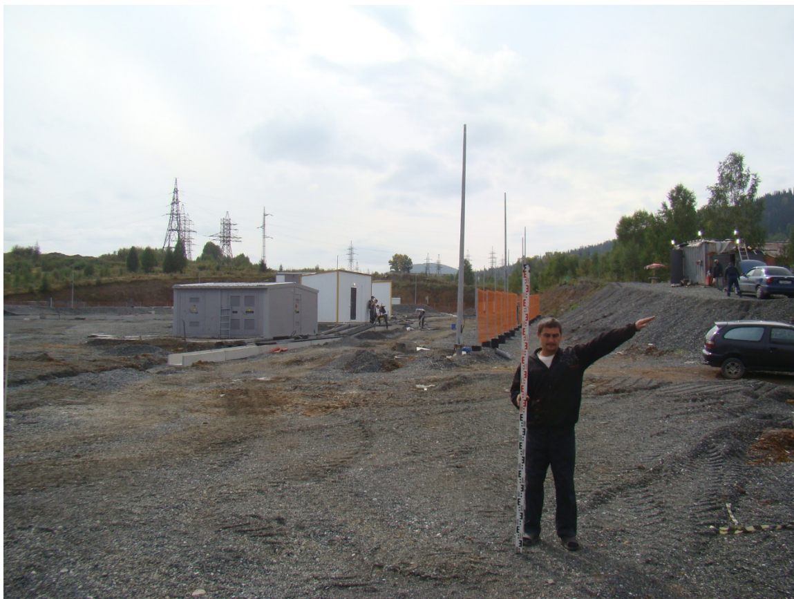
Рис. 9. Вскрытие и отработка запасов Шерегешевского месторождения. Точка фотофиксации № 1 ( 52^{\circ}55'10.32''\text{C} 87^{\circ}59'0.72''\text{B} ). Фото с В.
