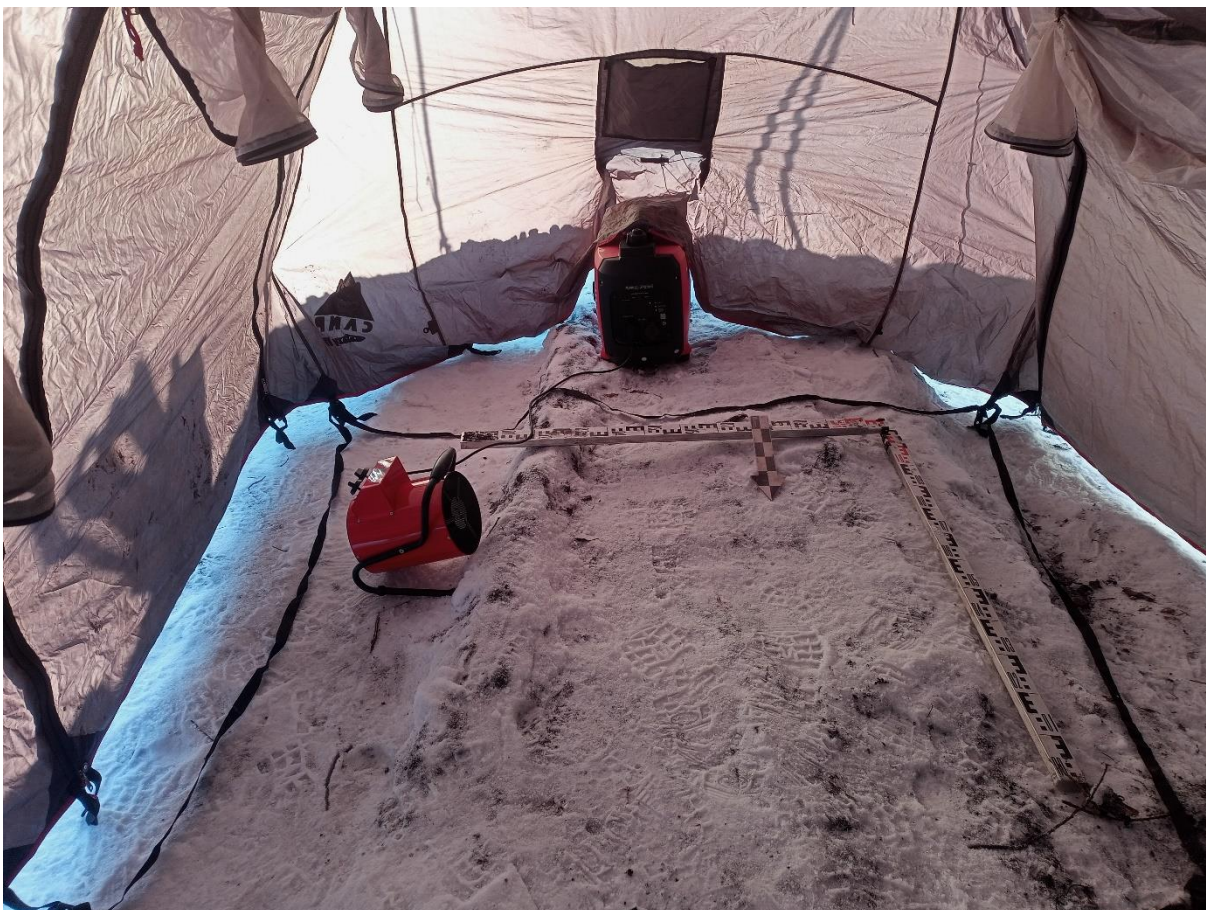
Рис. 65. «Строительство многоквартирных жилых домов ...». Шурф №2. Процесс отопления павильона и прогрева грунта. Фото с С.
