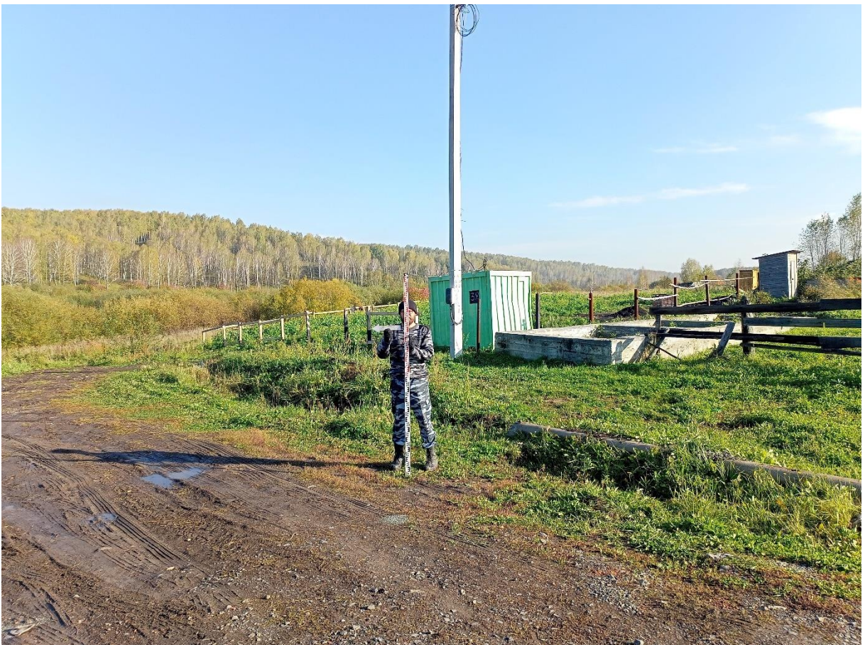
Рис. 31. «Строительство канализационной и тепловой сетей п. Новосафоновский». Точка фотофиксации №4 ( 53^{\circ}51'19.76''\text{C} , 86^{\circ}36'19.52''\text{B} ). Фото с З.
