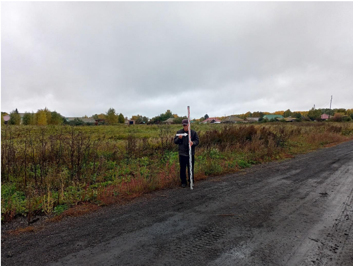
Рис. 132. «Строительство тепловой сети п. Трудармейский». Точка фотофиксации №20 ( 54^{\circ} 7'1.39''\text{С} , 86^{\circ}24'46.71''\text{В} ). Фото с В.
