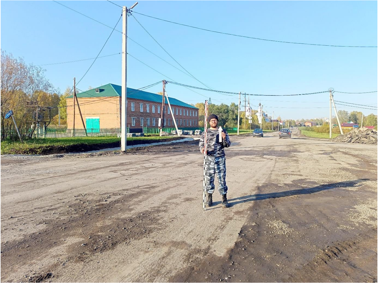
Рис. 50. «Строительство канализационной и тепловой сетей п. Новосафоновский». Точка фотофиксации №9 ( 53^{\circ}51'20.94''\text{C} , 86^{\circ}35'39.37''\text{В} ). Фото с Ю.
