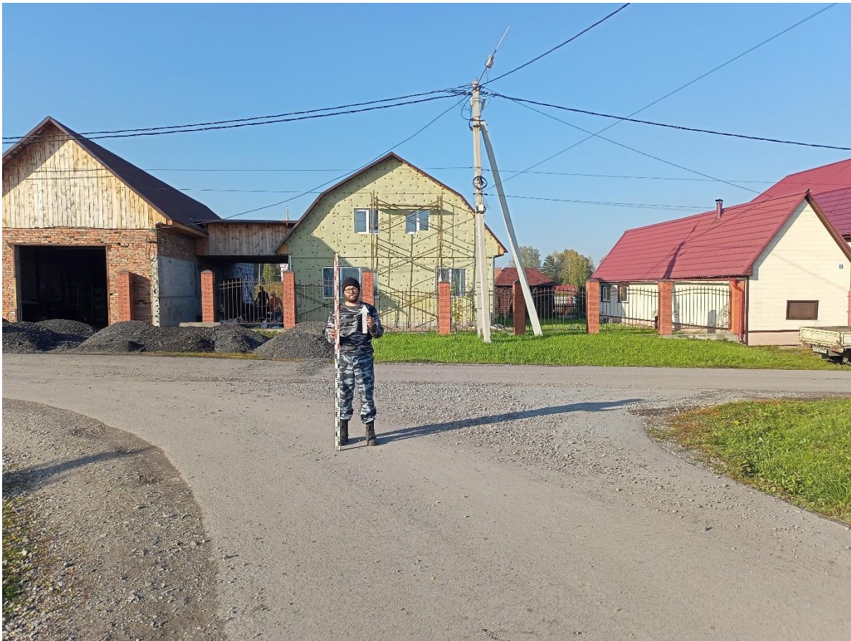
Рис. 42. «Строительство канализационной и тепловой сетей п. Новосафоновский». Точка фотофиксации №7 ( 53^{\circ}51'21.33''\text{С} , 86^{\circ}35'45.61''\text{В} ). Фото с Ю.
