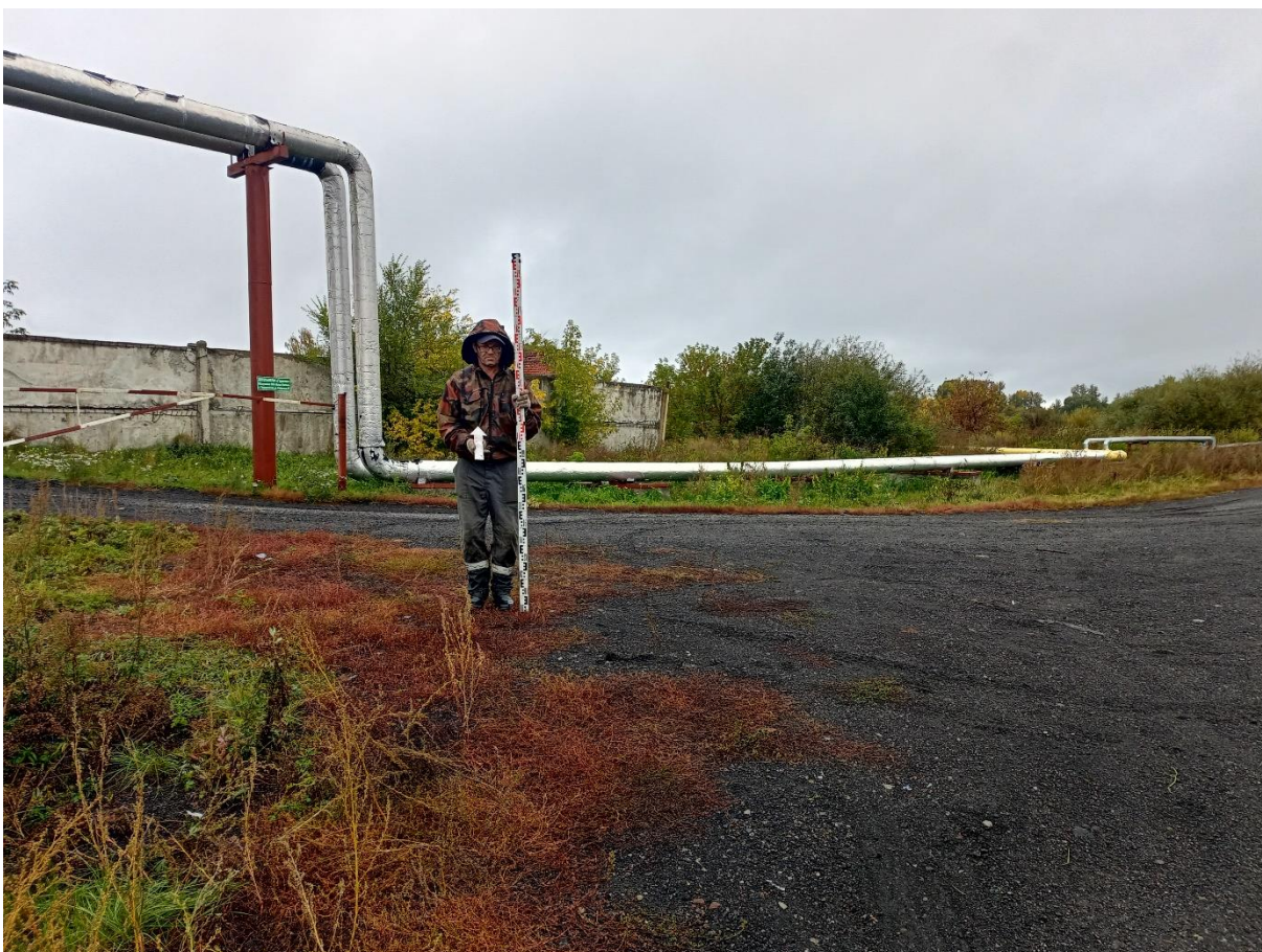
Рис. 129. «Строительство тепловой сети п. Трудармейский». Точка фотофиксации №19 ( 54^{\circ} 6'53.54''\text{C} , 86^{\circ}24'35.85''\text{B} ). Фото с Ю.
