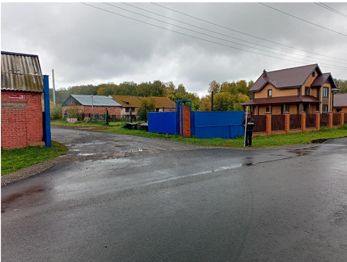
Рис. 163. «Строительство тепловой сети п. Трудармейский». Точка фотофиксации №28 ( 54^{\circ} 7'31.34''\text{C} , 86^{\circ}24'56.70''\text{B} ). Фото с З.
