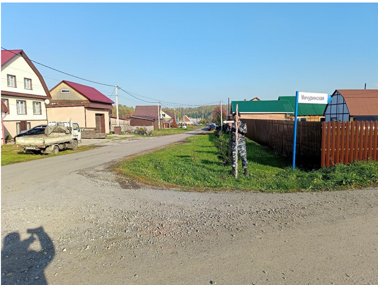
Рис. 43. «Строительство канализационной и тепловой сетей п. Новосафоновский». Точка фотофиксации №7 ( 53^{\circ}51'21.33''\text{С} , 86^{\circ}35'45.61''\text{В} ). Фото с З.
