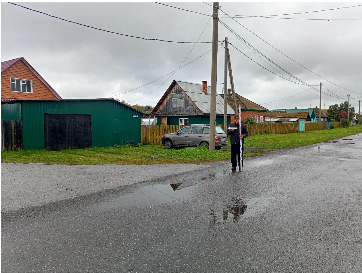
Рис. 151. «Строительство тепловой сети п. Трудармейский». Точка фотофиксации №25 ( 54^{\circ} 7'24.35''\text{С} , 86^{\circ}24'55.17''\text{В} ). Фото с З.
