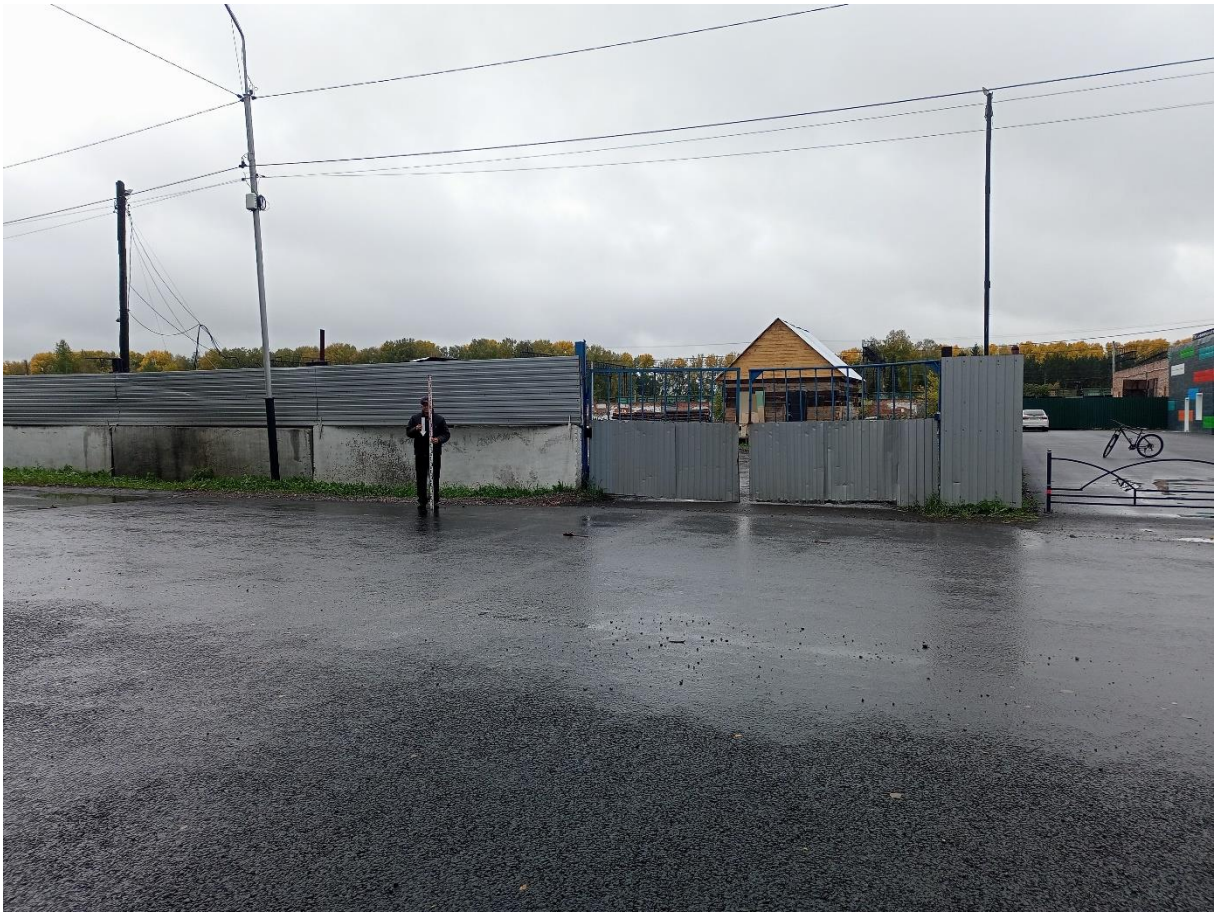
Рис. 144. «Строительство тепловой сети п. Трудармейский». Точка фотофиксации №23 ( 54^{\circ} 7'37.21''\text{С} , 86^{\circ}24'30.34''\text{В} ). Фото с с.
