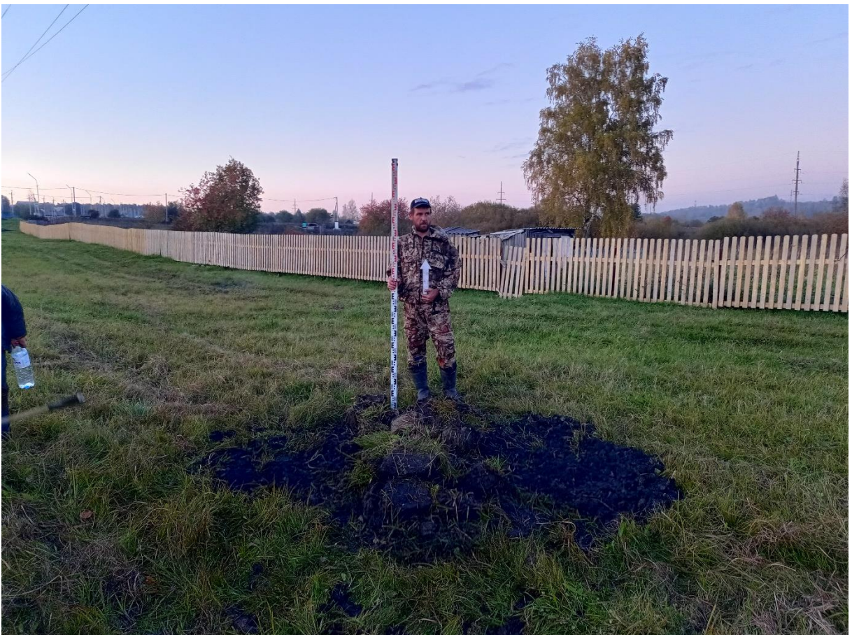
Рис. 113. «Строительство канализационной и тепловой сетей п. Новосафоновский». Шурф №6. Рекультивация. Фото с Ю.
