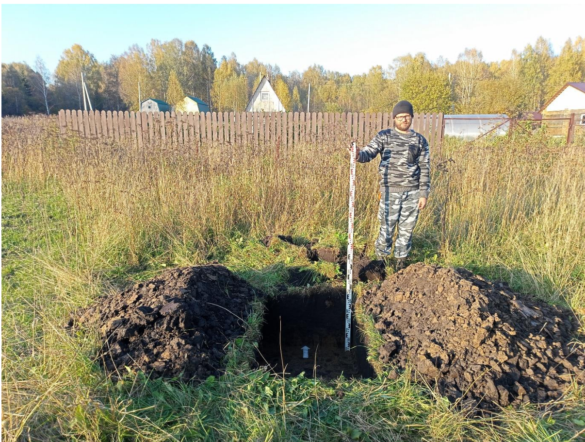
Рис. 107. «Строительство канализационной и тепловой сетей п. Новосафоновский». Шурф №5 после выборки. Фото с Ю.
