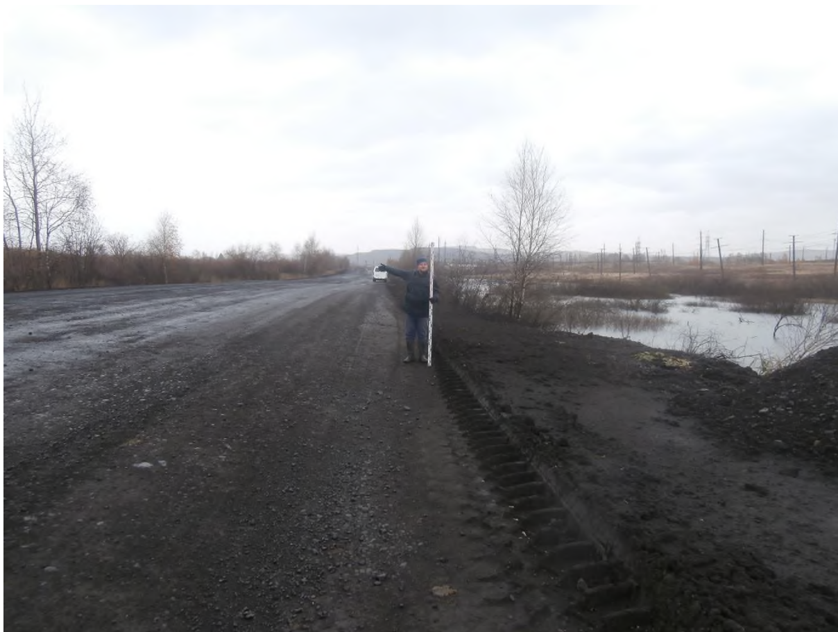
Рис. 40. «Строительство одной двухцепной отпайки .... КеНоТЭК». Точка фотофиксации №1 ( 54^{\circ}23'35.03''\text{С} , 86^{\circ}46'52.76''\text{В} ). Фото с З.
