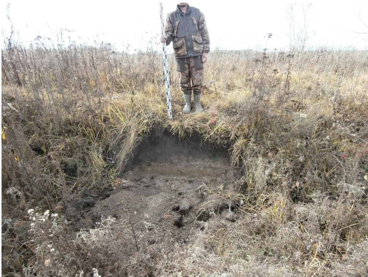
Рис. 272. «Строительство одной двухцепной отпайки .... КеНоТЭК». Зачистка №4 после производства работ. Фото с В.
