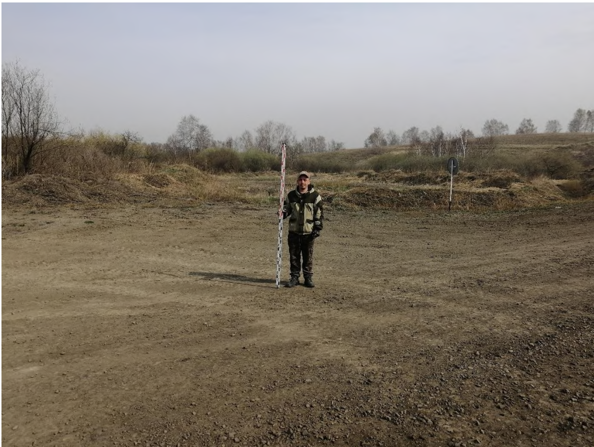
Рис. 101. «Строительство одной двухцепной отпайки .... КеНоТЭК». Точка фотофиксации №31 ( 54^{\circ}24'46.67''\text{С} , 86^{\circ}42'50.41''\text{В} ). Фото с Ю.
