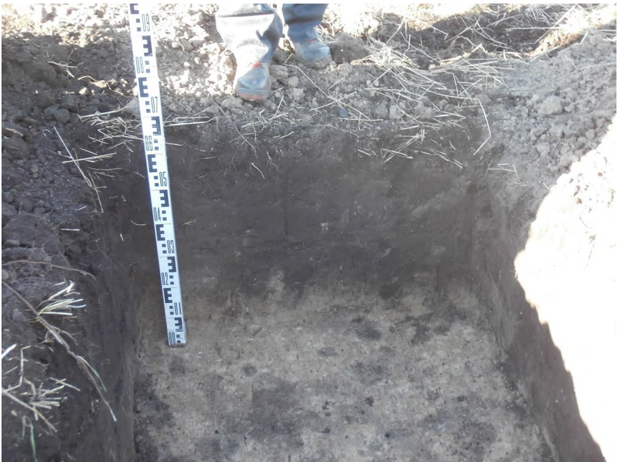
Рис. 213. «Строительство одной двухцепной отпайки .... КеНоТЭК». Шурф №26. Профиль западной стенки. Фото с В.
