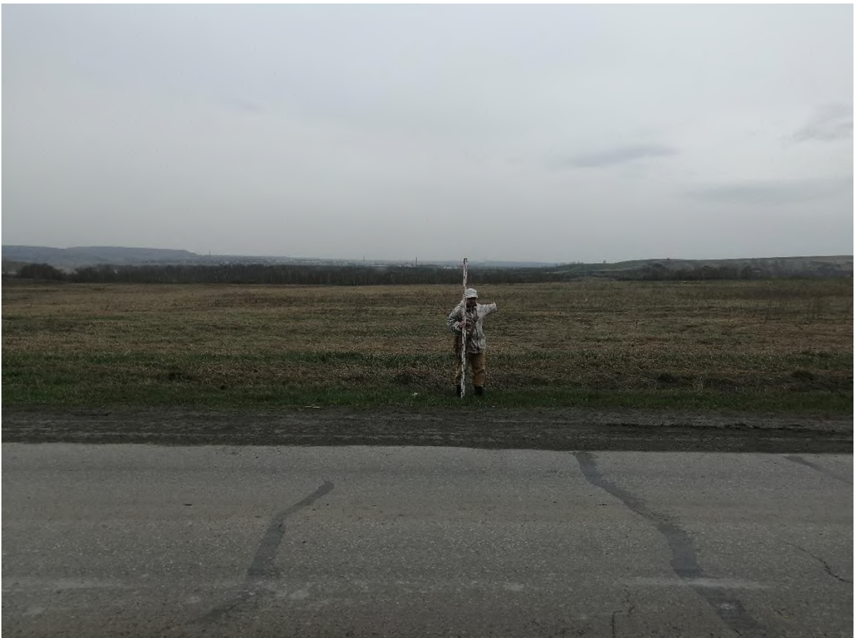
Рис. 112. «Строительство одной двухцепной отпайки .... КеНоТЭК». Точка фотофиксации №36 ( 54^{\circ}22'50.44''\text{С} , 86^{\circ}45'42.68''\text{В} ). Фото с ВЮВ.
