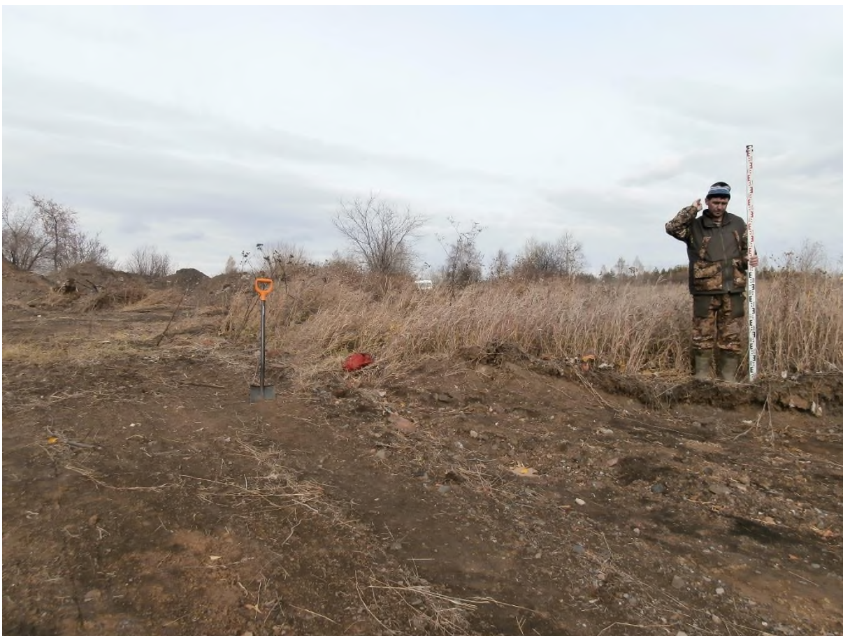
Рис. 269. «Строительство одной двухцепной отпайки .... КеНоТЭК». Место производства зачистки №3 ( 54^{\circ}23'19.67''\text{С} , 86^{\circ}43'28.51''\text{В} ). Фото с Ю.
