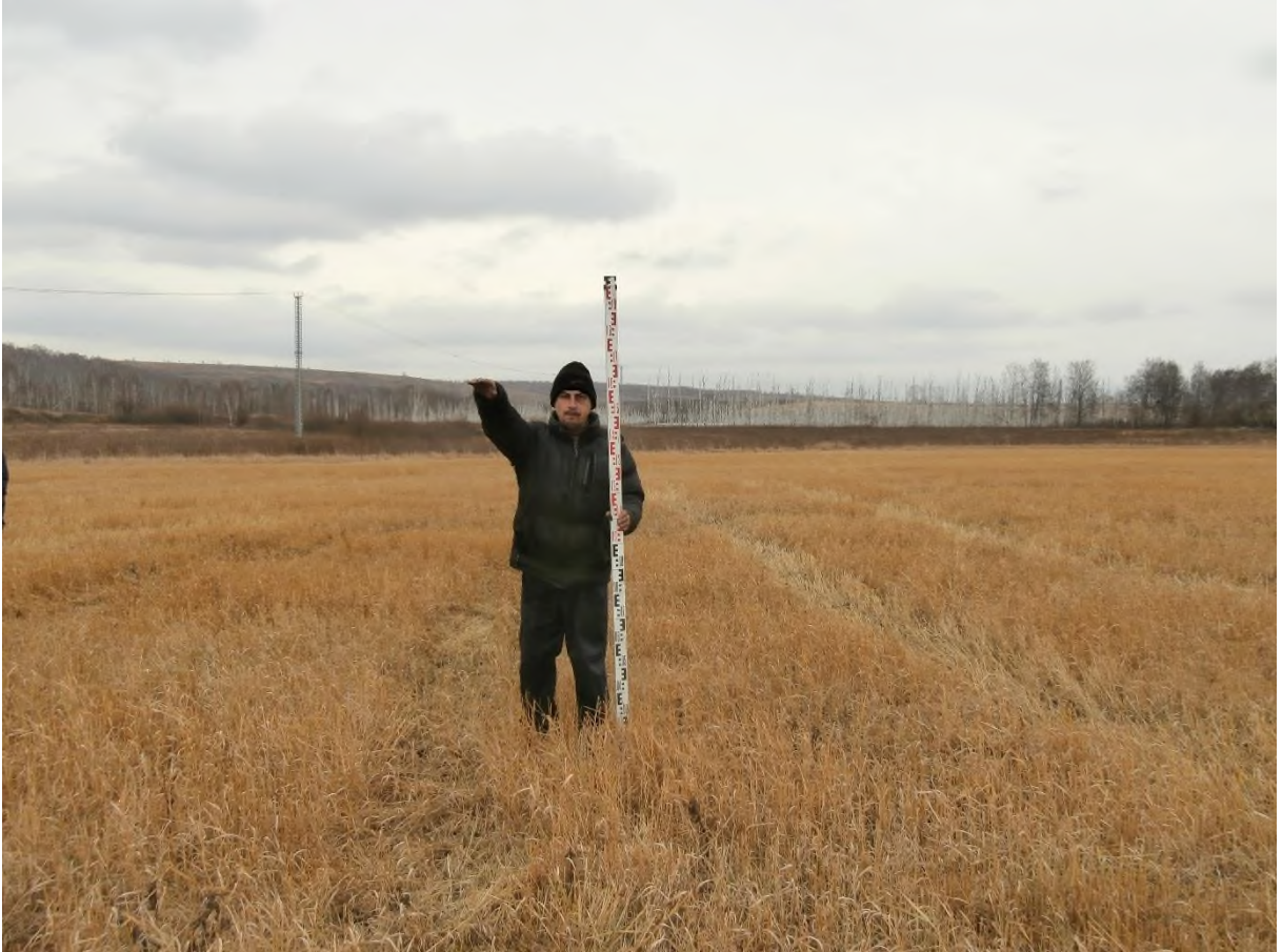
Рис. 155. «Строительство одной двухцепной отпайки .... КеНоТЭК». Шурф №12 ( 54^{\circ}25'32.36''\text{С} , 86^{\circ}41'45.24''\text{В} ). Место закладки. Фото с С.
