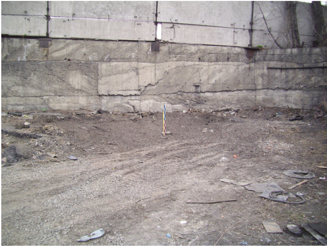
Рис. 16. Разрушения балластного покрытия на северо-восточной границе участка. Снято с 3.
