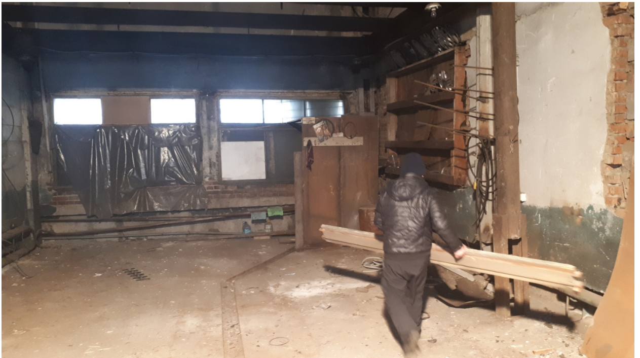
Рис. 17. Одно из старых производственных помещений на территории участка проектируемых работ, на заглублённом бетонном основании.
