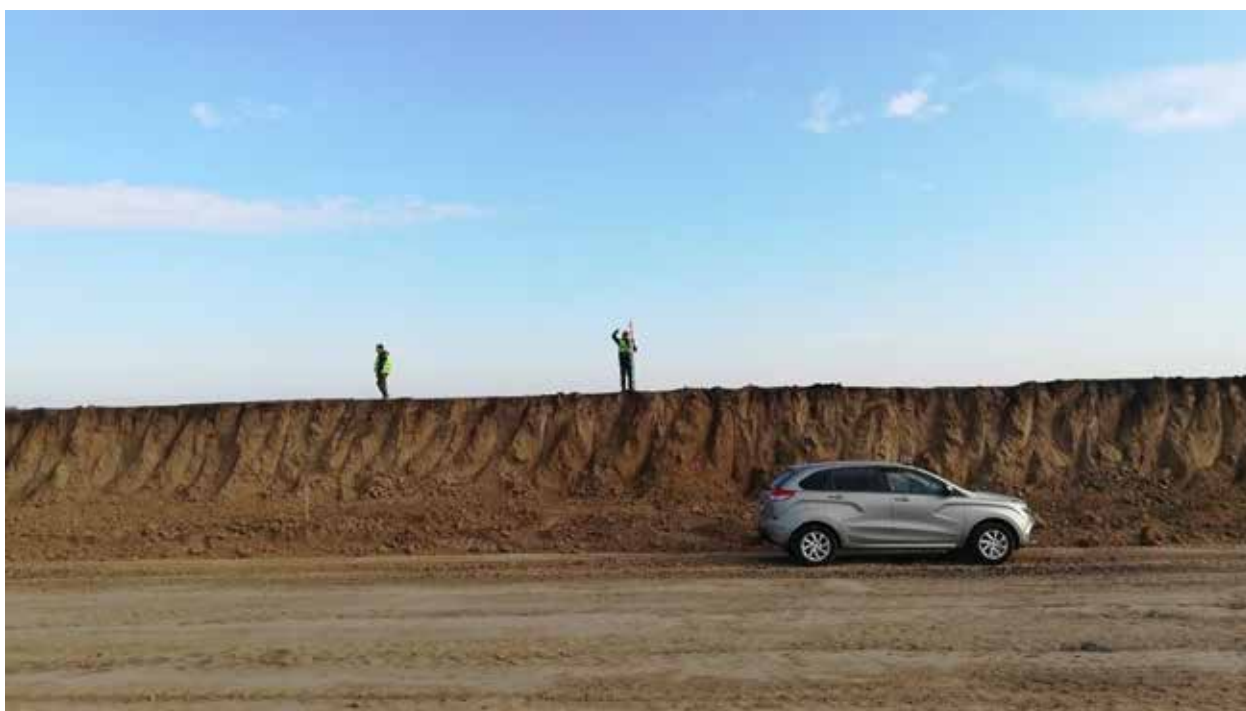
Рис. 176. Объект «Строительство железнодорожных путей ООО «Шахта Сибирская». Место зачистки 9. Координаты 54^{\circ}31'12.61''\text{С} 86^{\circ}16'52.08''\text{В} . Вид на С.
