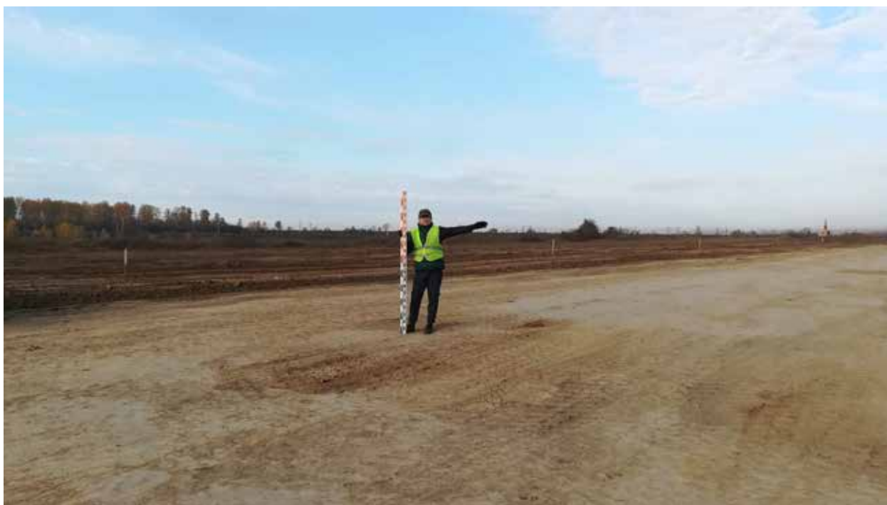
Рис. 151. Объект «Строительство железнодорожных путей ООО «Шахта Сибирская». Точка фотофиксации 14. Координаты 54^{\circ}31'15.01''\text{С} 86^{\circ}16'37.97''\text{В} . Вид на З.
