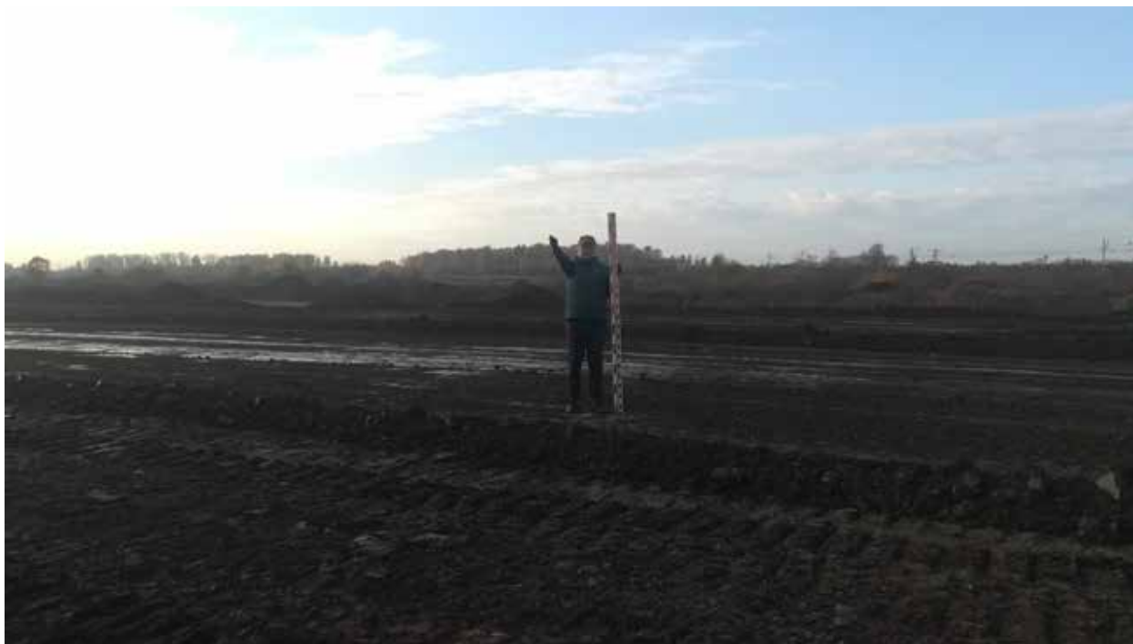
Рис. 142. Объект «Строительство железнодорожных путей ООО «Шахта Сибирская». Точка фотофиксации 12. Координаты 54^{\circ}31'23.70''\text{С} 86^{\circ}16'11.25''\text{В} . Вид на Ю.
