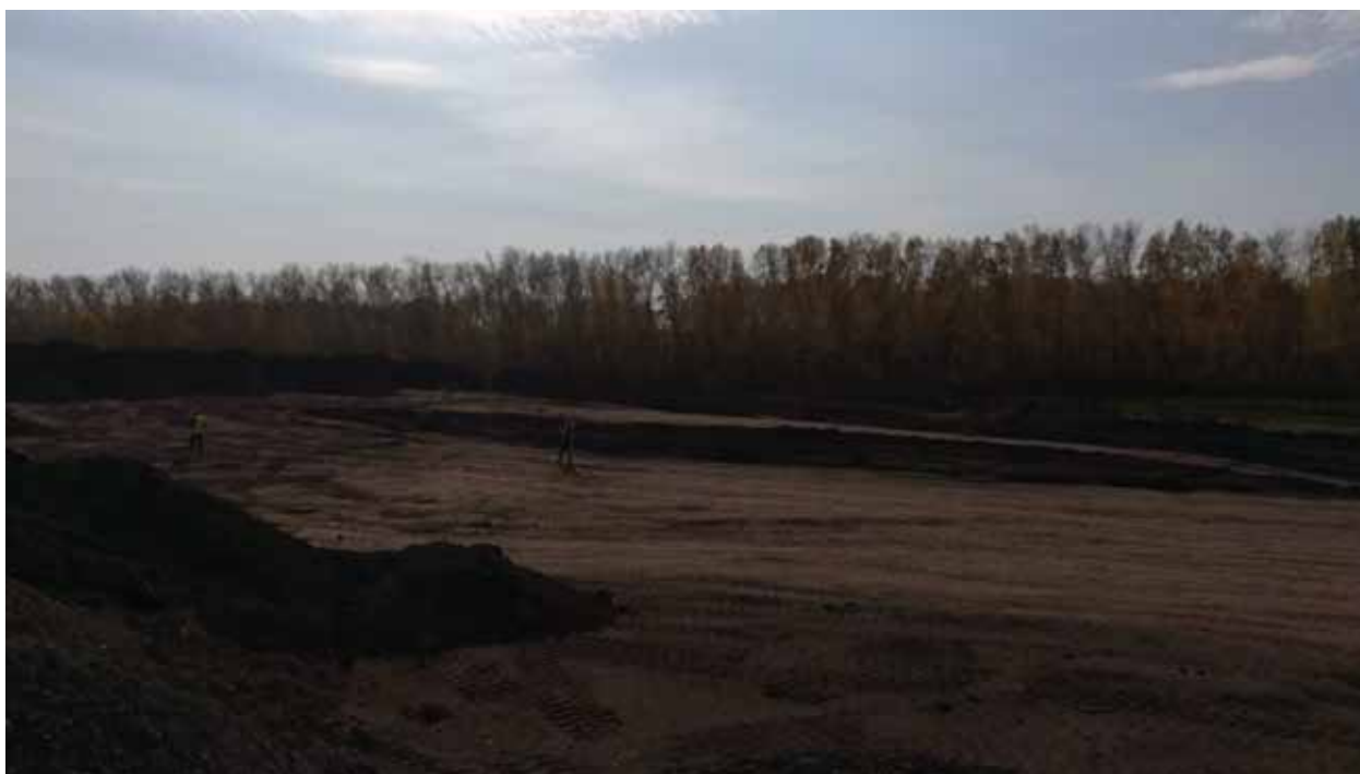
Рис. 169. Объект «Строительство железнодорожных путей ООО «Шахта Сибирская». Точка фотофиксации 20. Координаты 54°30'46.98"С 86°17'40.35"В. Вид на Ю.
