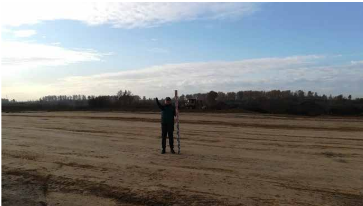
Рис. 146. Объект «Строительство железнодорожных путей ООО «Шахта Сибирская». Точка фотофиксации 13. Координаты 54^{\circ}31'19.36''\text{С} 86^{\circ}16'20.85''\text{В} . Вид на Ю.
