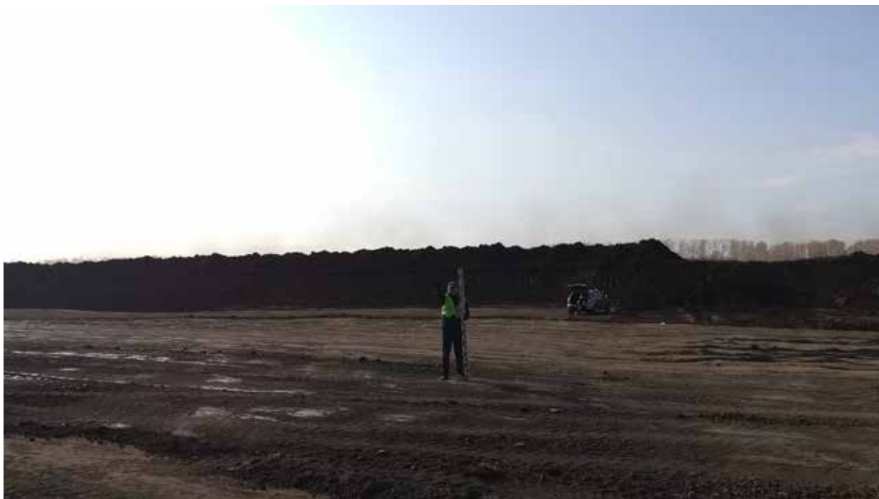
Рис. 156. Объект «Строительство железнодорожных путей ООО «Шахта Сибирская». Точка фотофиксации 16. Координаты 54°31'10.33"С 86°16'50.98"В. Вид на Ю.
