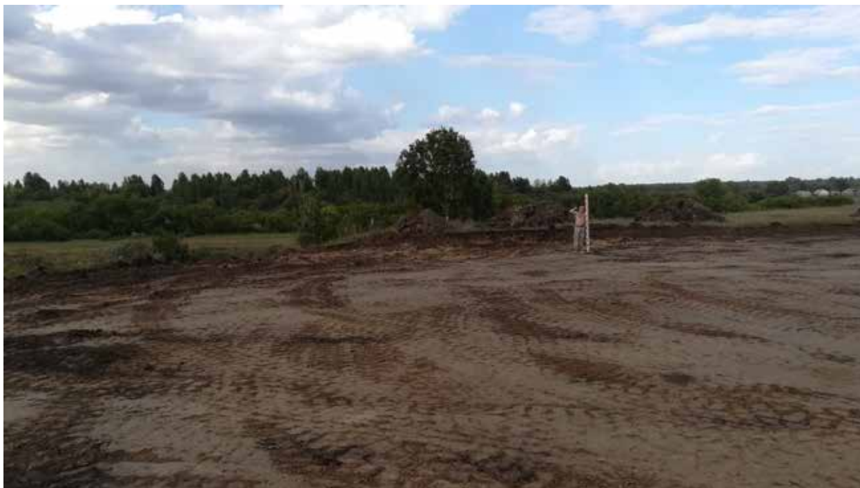
Рис. 21. Объект «Обогатительная фабрика «Шахта Сибирская». Точка фотофиксации 6. Координаты 54°31'25.08"С 86°16'45.38"В. Вид на С.
