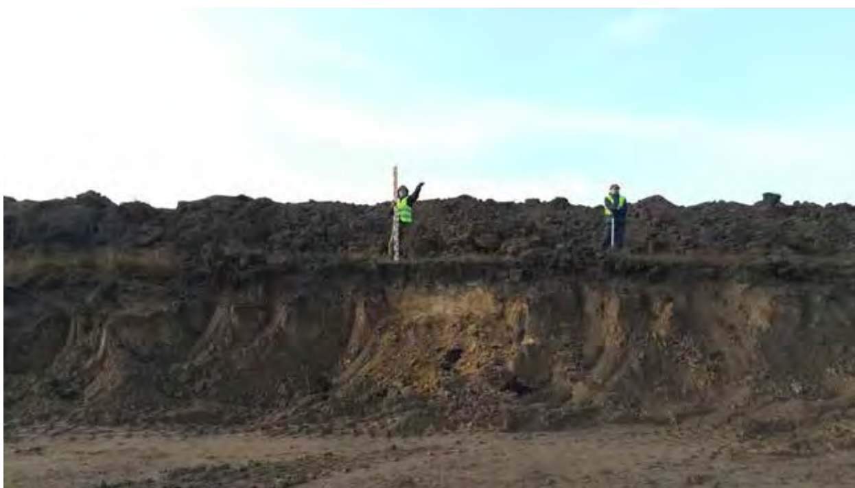
Рис. 171. Объект «Строительство железнодорожных путей ООО «Шахта Сибирская». Зачистка 7 после завершения работ. Вид на Ю.
