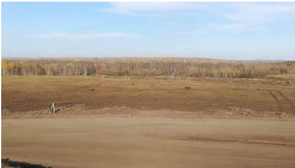
Рис. 168. Объект «Строительство железнодорожных путей ООО «Шахта Сибирская». Точка фотофиксации 20. Координаты 54°30'46.98"С 86°17'40.35"В. Вид на С.
