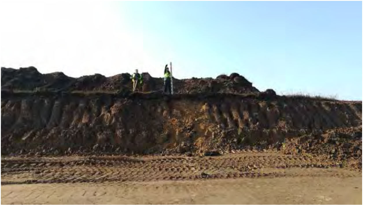
Рис. 180. Объект «Строительство железнодорожных путей ООО «Шахта Сибирская». Зачистка 10 после завершения работ. Вид на Ю.
