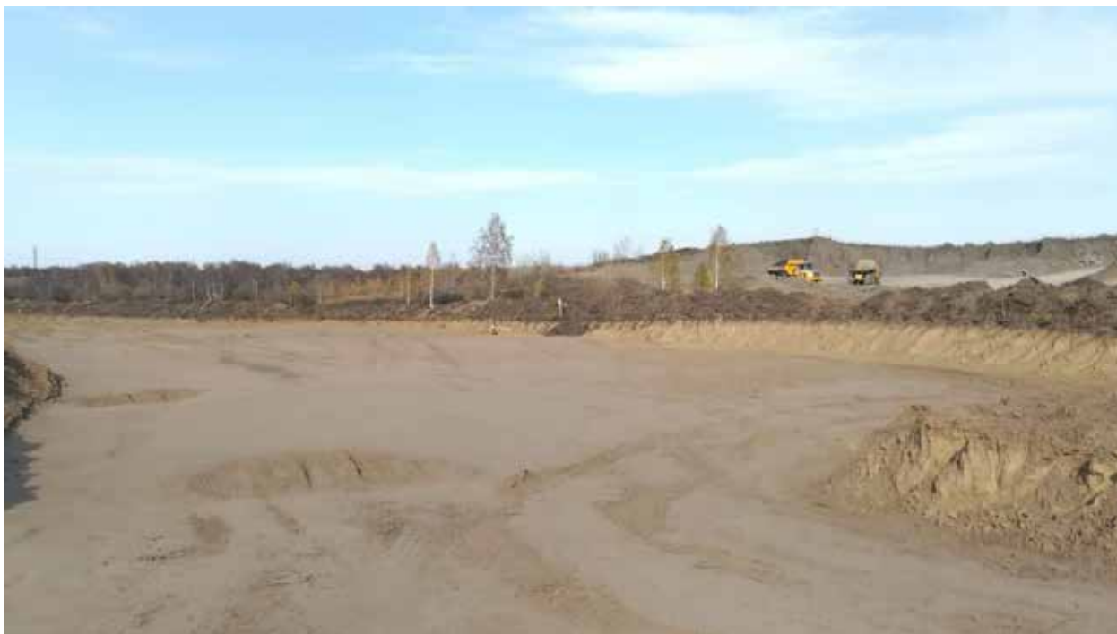
Рис. 196. Объект «Строительство железнодорожных путей ООО «Шахта Сибирская». Место зачистки 14. Координаты 54°30'49.94"С 86°17'46.95"В. Вид на СЗ.
