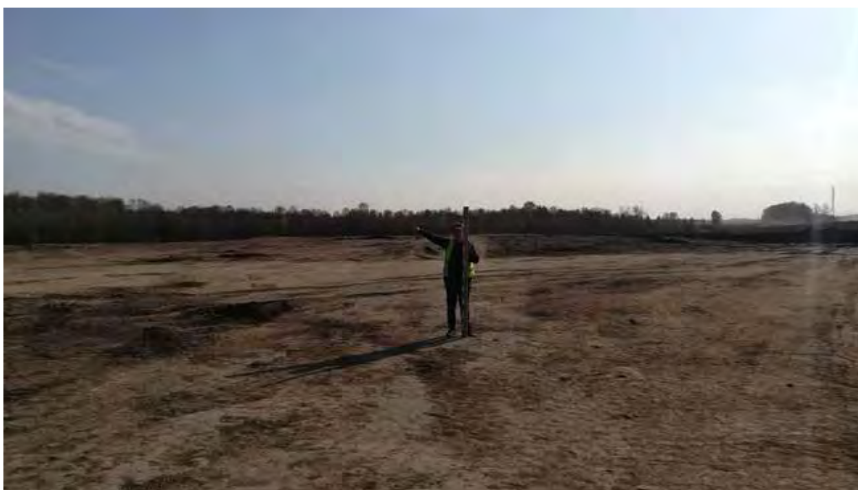
Рис. 159. Объект «Строительство железнодорожных путей ООО «Шахта Сибирская». Точка фотофиксации 17. Координаты 54^{\circ}31'5.36''\text{С} 86^{\circ}17'6.12''\text{В} . Вид на В.
