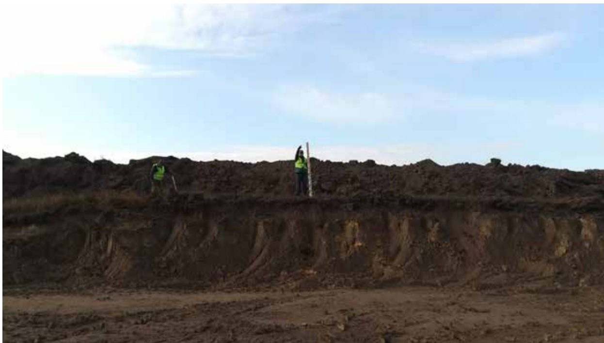
Рис. 170. Объект «Строительство железнодорожных путей ООО «Шахта Сибирская». Место зачистки 7. Координаты 54°31'11.38"С 86°16'39.93"В. Вид на Ю.
