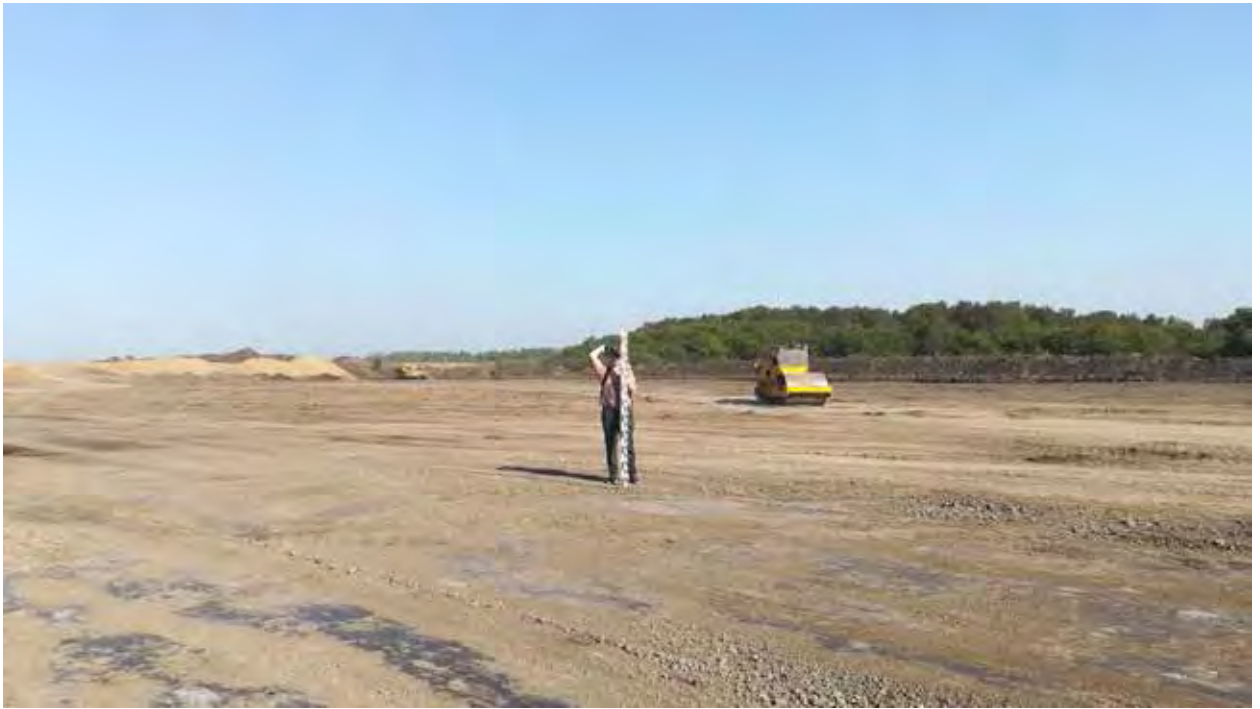
Рис. 7. Объект «Обогатительная фабрика «Шахта Сибирская». Точка фотофиксации 1. Координаты 54°31'1.36"С 86°17'15.32"В. Вид на С.
