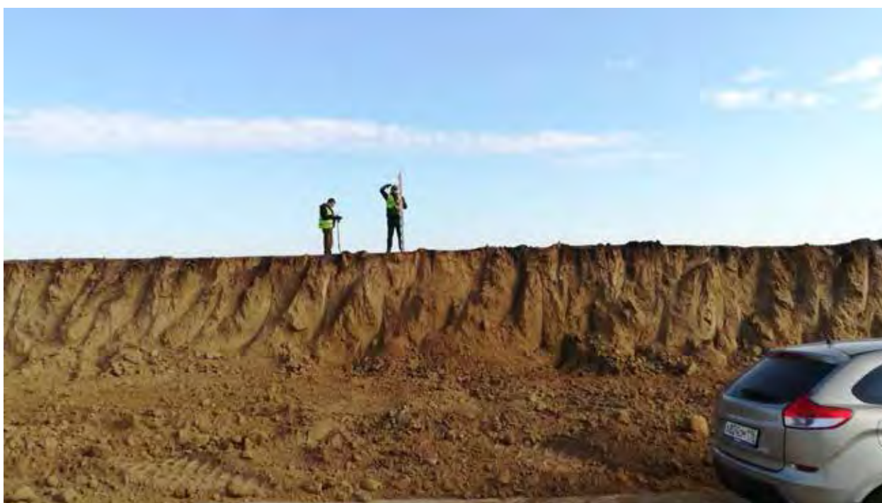
Рис. 177. Объект «Строительство железнодорожных путей ООО «Шахта Сибирская». Зачистка 9 после завершения работ. Вид на С.
