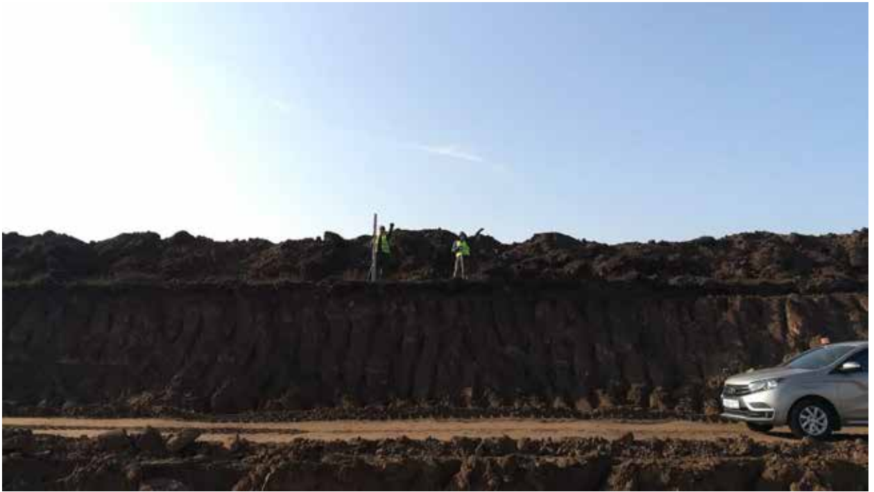
Рис. 182. Объект «Строительство железнодорожных путей ООО «Шахта Сибирская». Место зачистки 11. Координаты 54°31'5.23"С 86°16'59.61"В. Вид на Ю.
