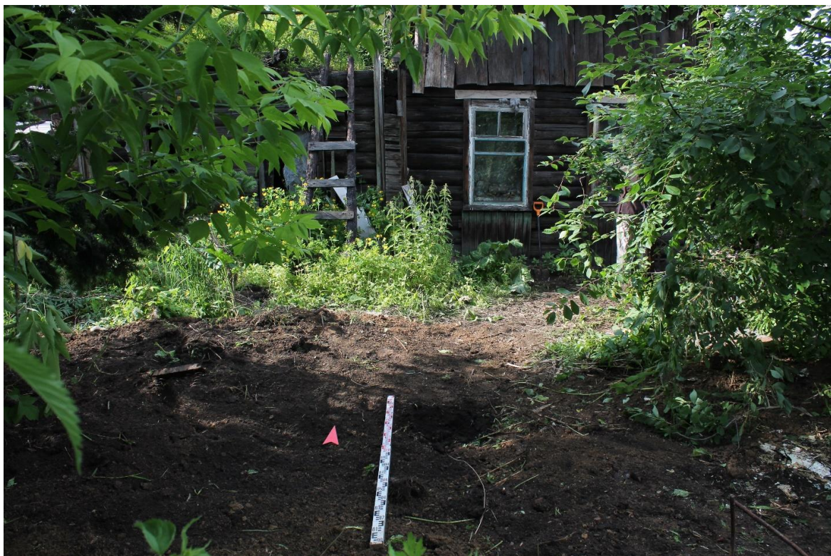
Рис.86. г. Новокузнецк, Кемеровская область, 2021 г. Участок-1. Шурф № 2. Вид после рекультивации, с юга
