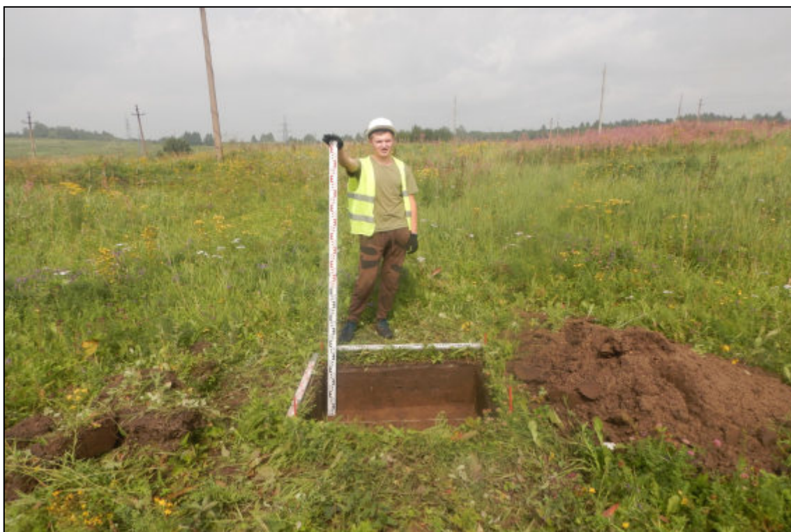
Рис. 280. Кемеровская область, Новокузнецкий муниципальный округ. «Объект размещения отходов АО «Шахта «Большевик». Корректировка». Шурф № 12. Вид после завершения земляных работ. Снято с юга.
