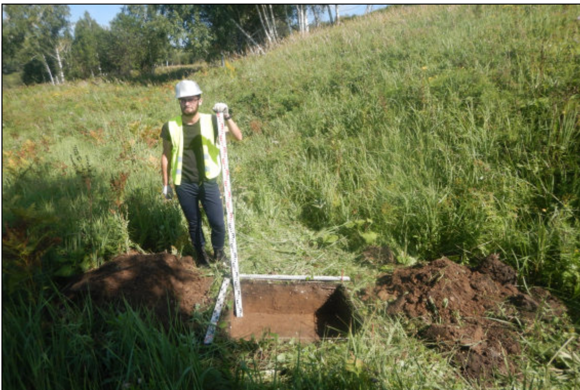
Рис. 320. Кемеровская область, Новокузнецкий муниципальный округ. «Объект размещения отходов АО «Шахта «Большевик». Корректировка». Шурф № 24. Вид после завершения земляных работ. Снято с юга.
