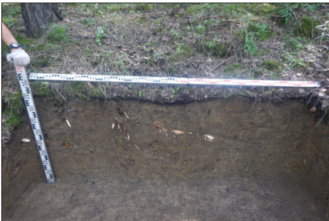
Рис. 404. Кемеровская область, Новокузнецкий муниципальный округ. «Объект размещения отходов АО «Шахта «Большевик». Корректировка». Зачистка № 49. Вид после завершения земляных работ. Снято с северо-запада.
