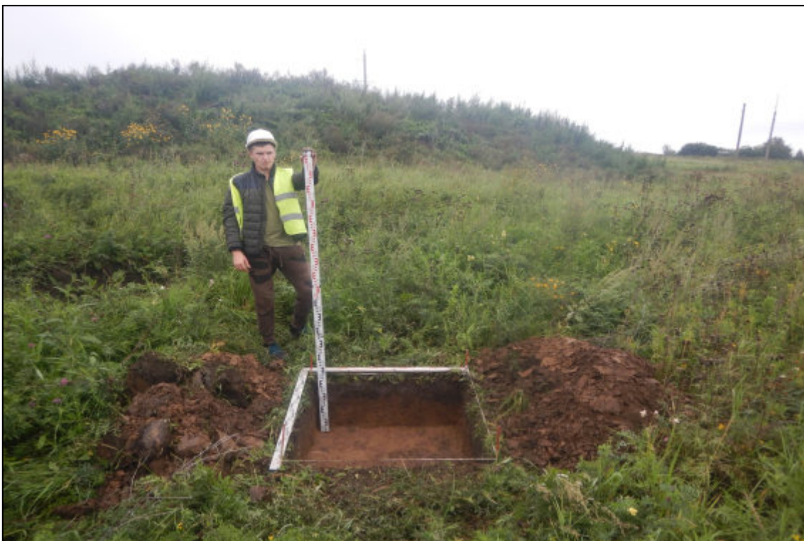
Рис. 272. Кемеровская область, Новокузнецкий муниципальный округ. «Объект размещения отходов АО «Шахта «Большевик». Корректировка». Шурф № 10. Вид после завершения земляных работ. Снято с юга.
