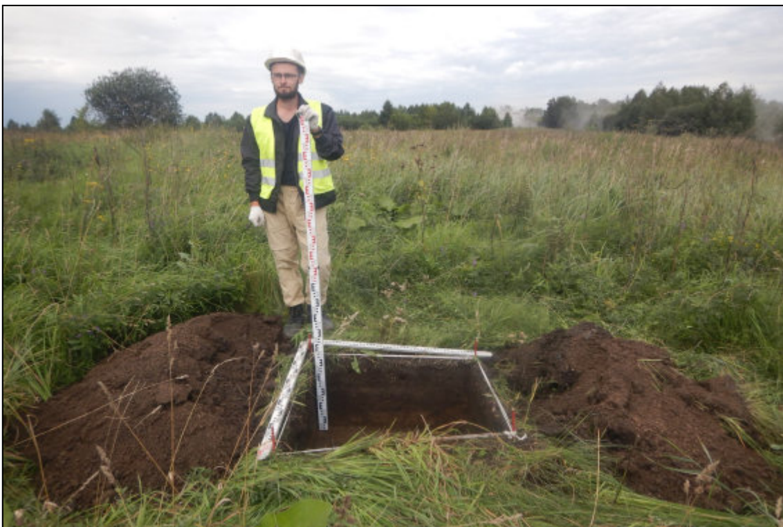
Рис. 258. Кемеровская область, Новокузнецкий муниципальный округ. «Объект размещения отходов АО «Шахта «Большевик». Корректировка». Шурф № 6. Вид после завершения земляных работ. Снято с юга.
