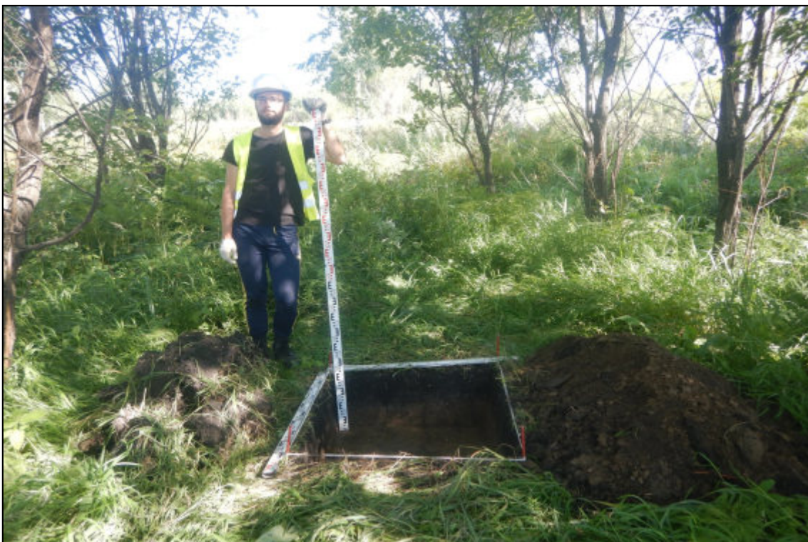
Рис. 324. Кемеровская область, Новокузнецкий муниципальный округ. «Объект размещения отходов АО «Шахта «Большевик». Корректировка». Шурф № 25. Вид после завершения земляных работ. Снято с юга.
