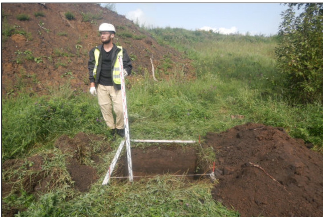
Рис. 284. Кемеровская область, Новокузнецкий муниципальный округ. «Объект размещения отходов АО «Шахта «Большевик». Корректировка». Шурф № 13. Вид после завершения земляных работ. Снято с юга.
