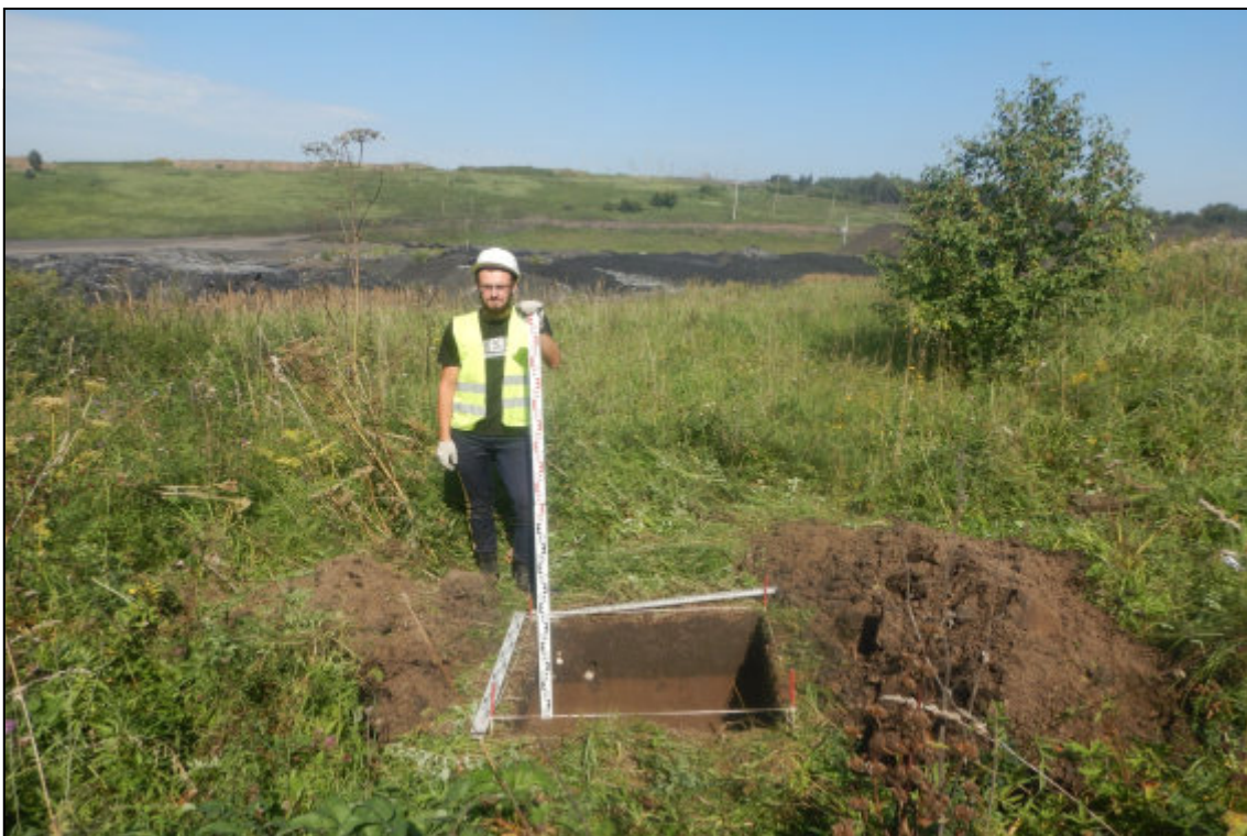
Рис. 380. Кемеровская область, Новокузнецкий муниципальный округ. «Объект размещения отходов АО «Шахта «Большевик». Корректировка». Шурф № 41. Вид после завершения земляных работ. Снято с юга.
