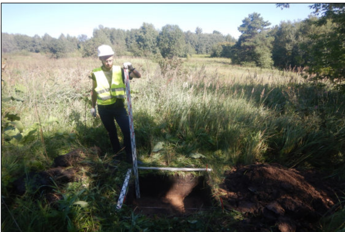
Рис. 366. Кемеровская область, Новокузнецкий муниципальный округ. «Объект размещения отходов АО «Шахта «Большевик». Корректировка». Шурф № 37. Вид после завершения земляных работ. Снято с юга.
