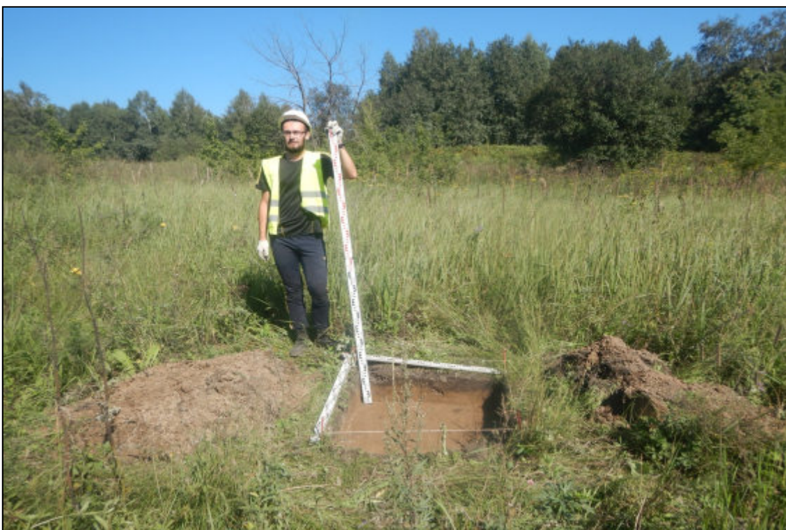
Рис. 362. Кемеровская область, Новокузнецкий муниципальный округ. «Объект размещения отходов АО «Шахта «Большевик». Корректировка». Шурф № 36. Вид после завершения земляных работ. Снято с юга.
