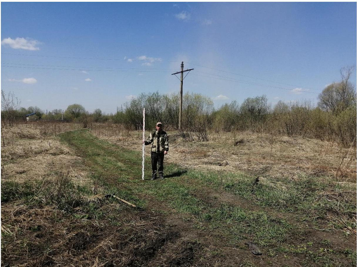
Рис. 26. «Строительство водовода от бункера существующих скважин до узла II подъема...». Точка фотофиксации №7 ( 53^{\circ}45'58.97''\text{С} , 87^{\circ}37'37.35''\text{В} ). Фото с ВЮВ.
