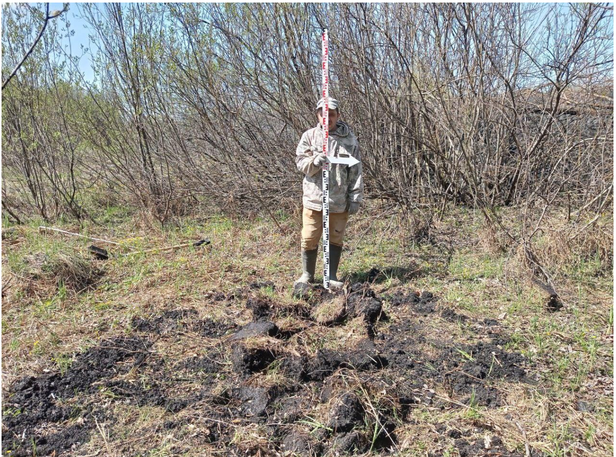
Рис. 70. «Строительство водовода от бункера существующих скважин до узла II подъема...». Шурф №6. Рекультивация. Фото с В.
