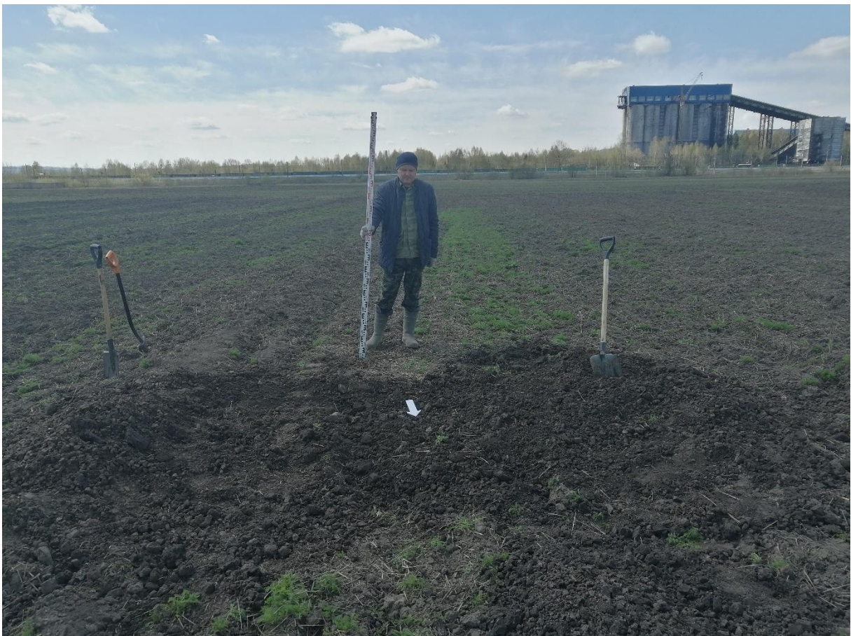
Рис. 50. «Строительство водовода от бункера существующих скважин до узла II подъема...». Шурф №1. Рекультивация. Фото с С.
