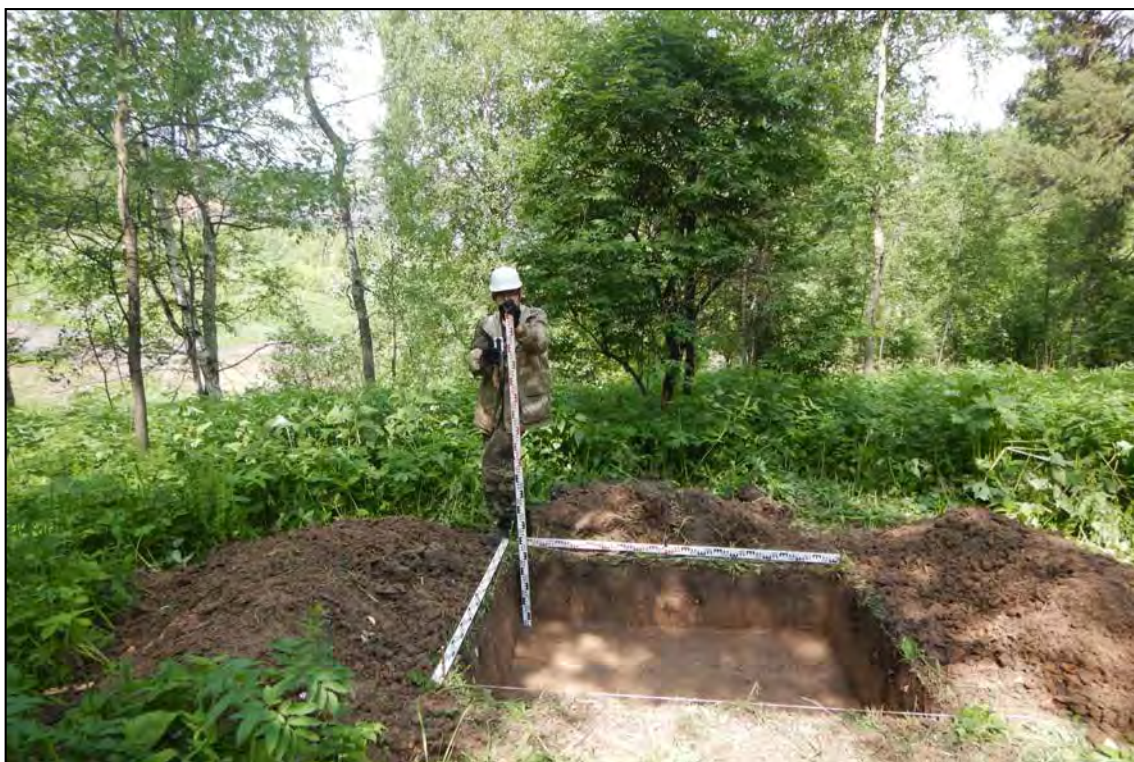
Рис. 110. «III очередь Щедрухинского породного отвала» 2 этап в Новокузнецком городском округе Кемеровской области. Шурф № 10. Вид после завершения земляных работ. Снято с Юга.
